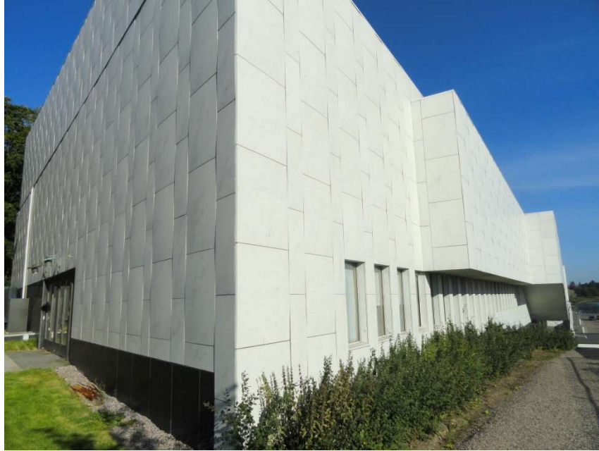
Figura 2. Vista parcial del Finlandia Hall donde el pandeo de las lajas de mármol de Carrara se puede ver claramente. (Foto Agosto 14, 2012. Cortesía de Daderot por Wikipedia Commons)
