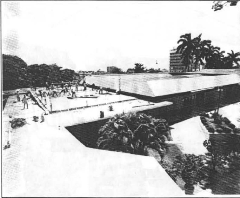
Construction progresses on the expansion of the Library and workers are pouring concrete on the first floor---Progresión la construcción de la expansión de la biblioteca y los trabajadores están colocando el concreto del primer alto.
