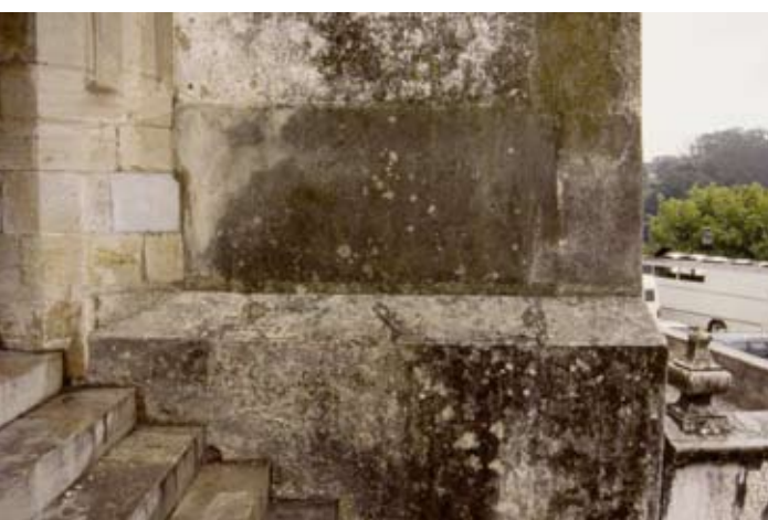
DETALLE DE LA VARIACIÓN DE DETERIORO QUE CORRESPONDE A LA VARIACIÓN DEL MORTERO UTILIZADO EN EL REVOQUE.
