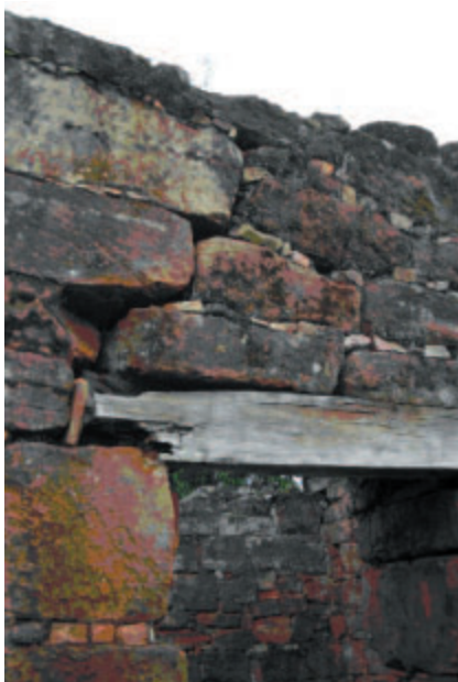
Fig. 11 - Dintel a punto de colapsar por el deterioro de la madera. San Ignacio Miní. Verga em risco de colapso pela deterioração da madeira. San Ignacio Miní.
