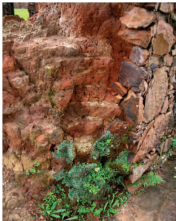
Fig. 13 der. Detalle mostrando el interior del muro y la colonización biológica que acelera el deterioro.
