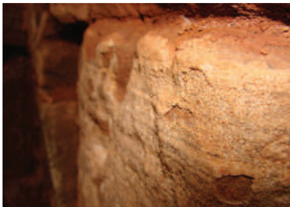
Figura 6. (a) Deterioro mecánico superficial por crecimiento de líquen crustoso mal llamado “hongo blanco” sobre asperón rojo.
