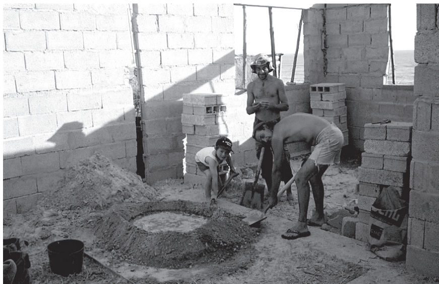
Figura 5 Amigos de Karumbé construyendo la casa comunal en San Luis (foto Karumbé)
